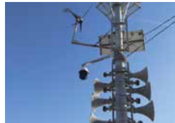
CCTV·음성 동보 시설
